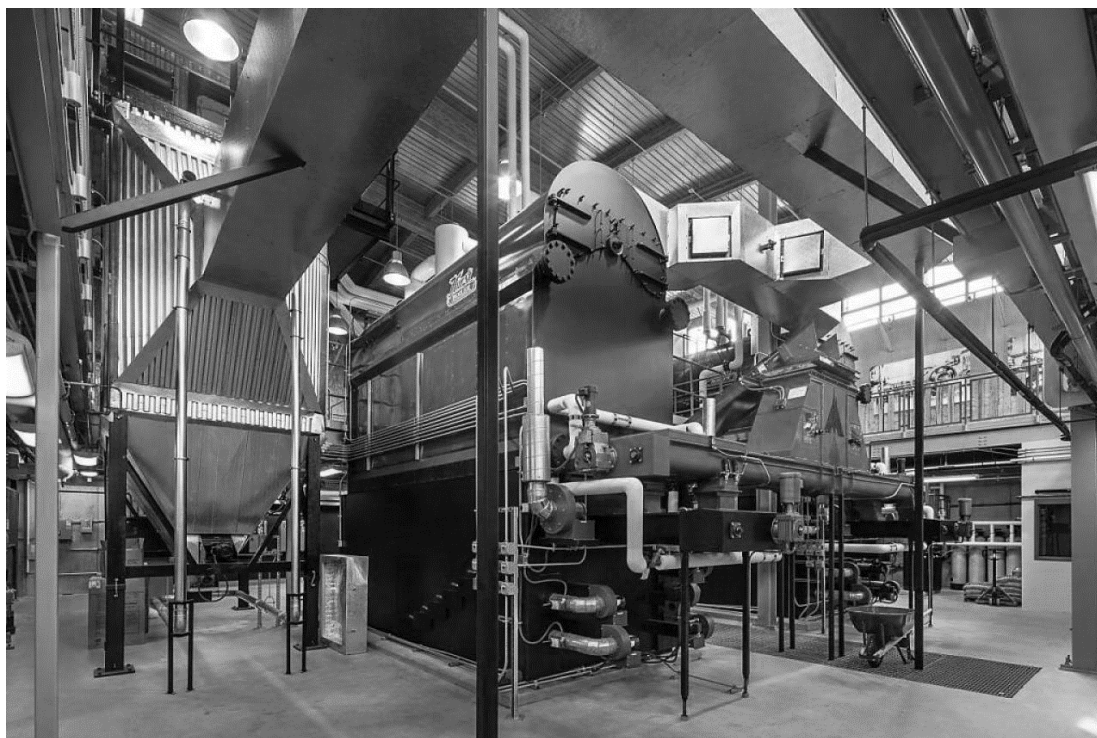
Рис. 4. Машинный зал котельной на древесных отходах в г. Мытищи (Московская область)
