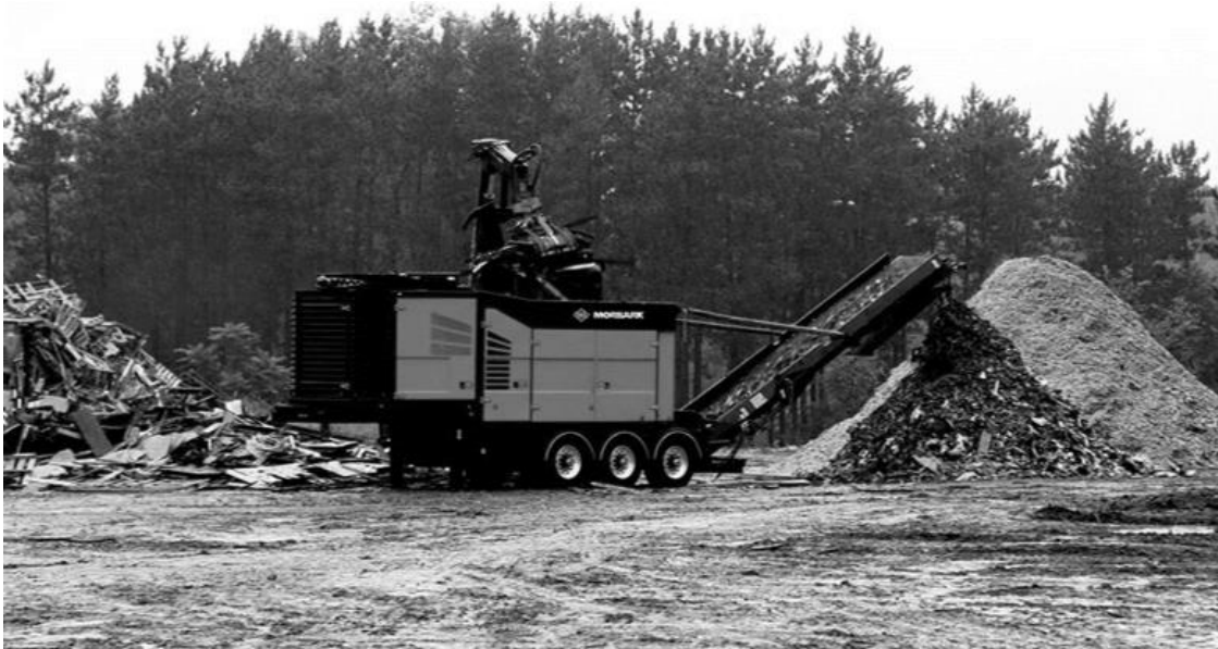
Рис. 2. Подготовка древесных отходов к сжиганию в котельной на площадке для резервного запаса топлива
